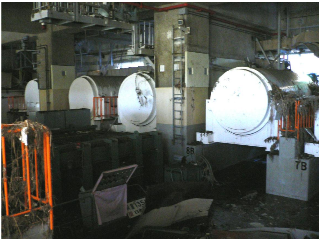
圖 17 日本福島電廠乾式貯存系統於海嘯前後之設施狀況(a)海嘯前；(b)海嘯後。(來源：東京電力公司公佈資料)
