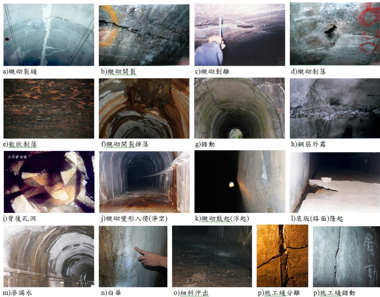
圖 4.1-4 常見的隧道襯砌異狀(王泰典等，2007)
