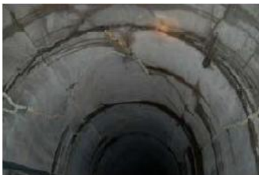
頂拱放射狀與起拱線縱向裂縫
