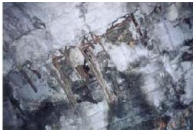
鋼筋外露(搭接處)
