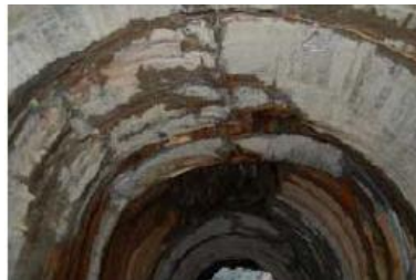
頂拱中間開裂與左側縱向裂縫
