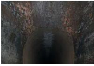
兩側起拱線上45°附近傘狀剝落
