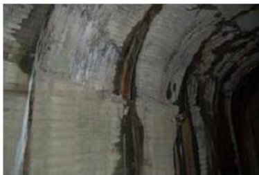
起拱線附近開裂錯動
