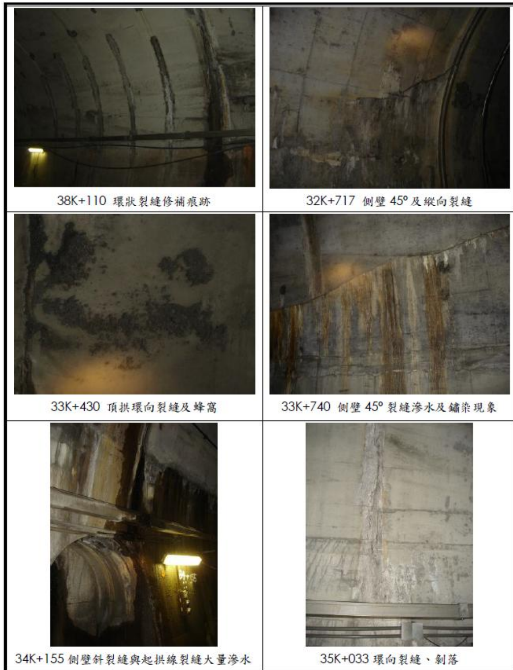
圖3.2-7 安朔隧道內襯砌現況及說明(交通部台灣鐵路管理局，2008)
