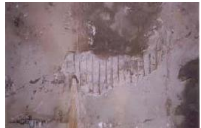
鋼筋外露(非搭接處、鋼筋挫屈)
