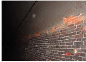
起拱線附近縱向剝落
