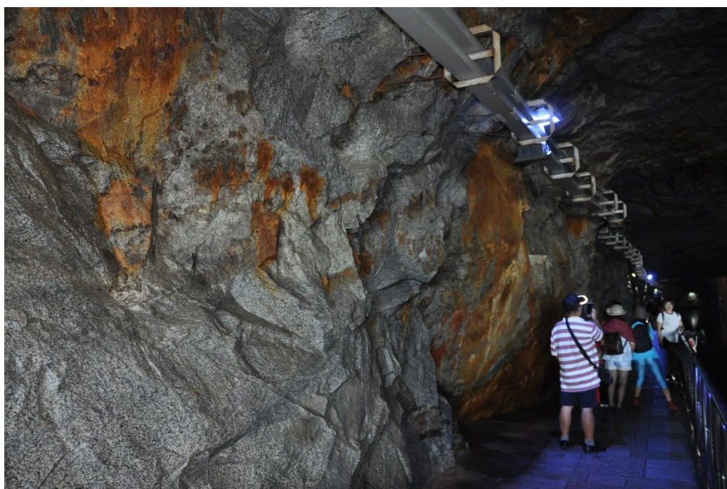
圖4.2-15 翟山坑道近出海口處節理密布，頂拱及側壁岩面呈現鏽染情況
