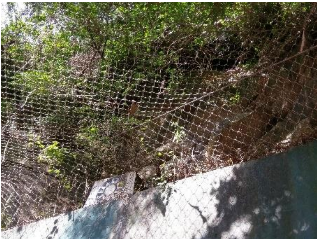
圖4.2-5 翟山坑道入口處洞口防護設施
