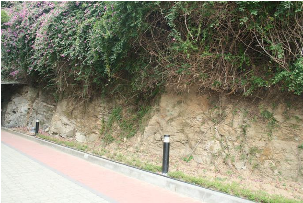
圖4.2-6 翟山坑道入口處岩坡風化情形
