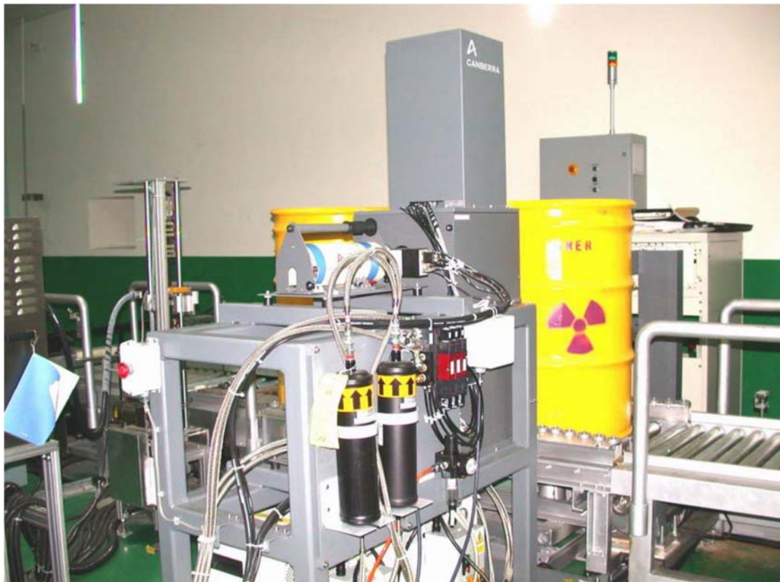
圖 4.2.5-2、核研所三貯庫廢棄物整桶加馬能譜計測設備
