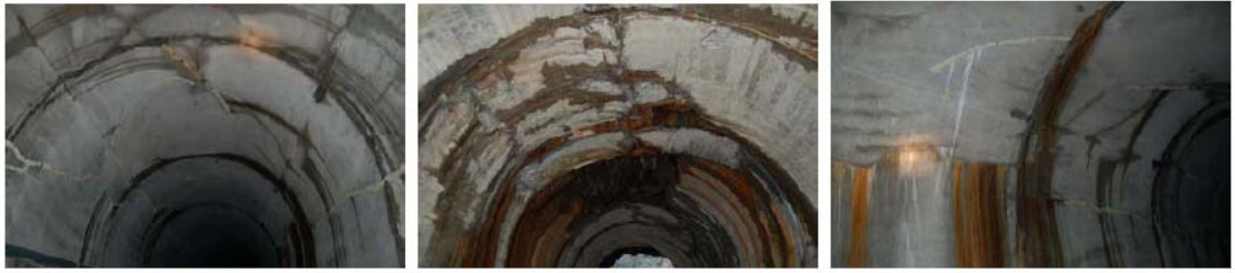
a)頂拱放射狀與起拱線縱向裂縫 b)頂拱中間開裂與左側縱向裂縫 c)起拱線附近平行縫與上方斜裂縫
