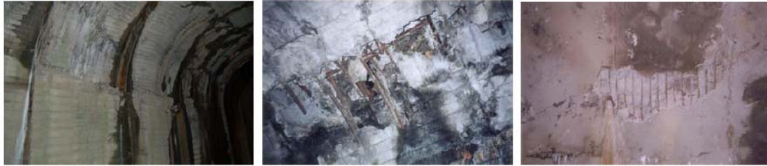
a)起拱線附近開裂錯動 b)鋼筋外露(搭接處) c)鋼筋外露(非搭接處、鋼筋挫屈)
