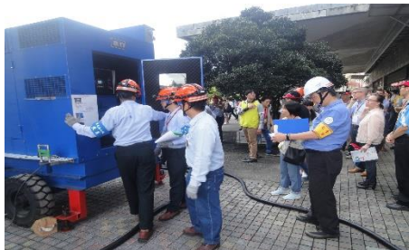
廠內移動電源 (480V) 連接演練
