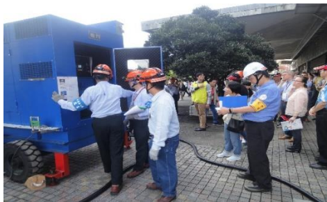
廠內移動電源(480V) 連接演練
