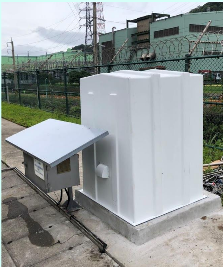
樁體內傾斜儀M04保護箱
