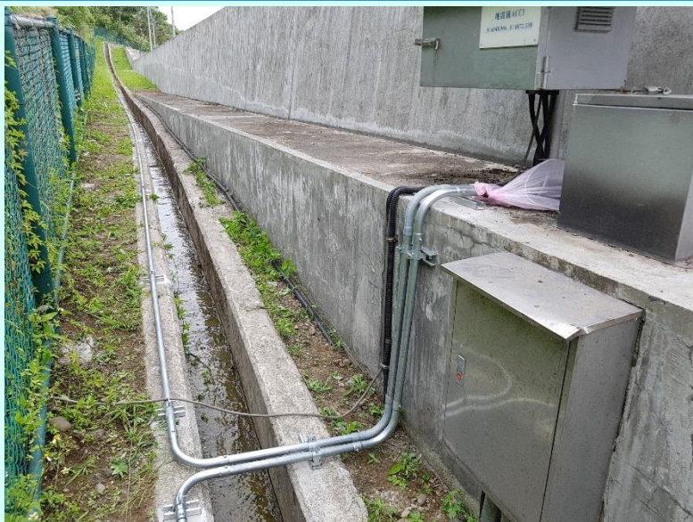
全系統管線重新配置
