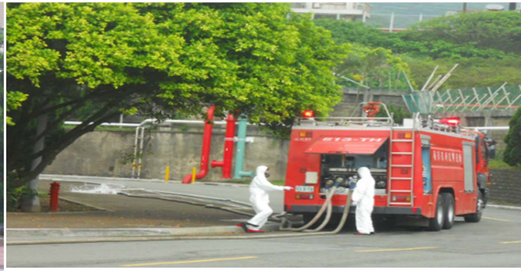
消防車載水補水進入反應爐
