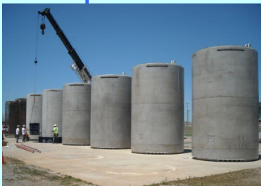
室外混凝土護箱(美國)
