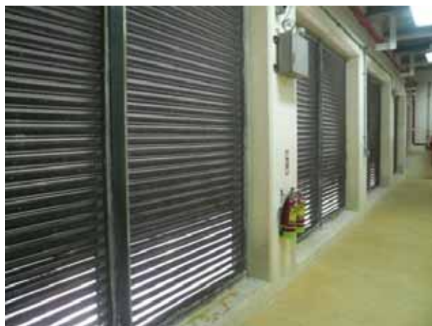
圖 8.2.4-24 五號緊急柴油發電機引擎冷卻口
