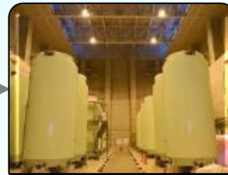
室內乾式 貯存設施
