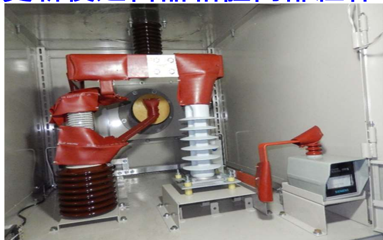
更新後避雷器箱體內部組件
