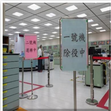
1/2號機共用控制室
