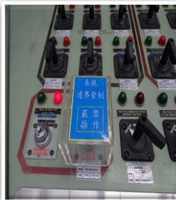
1號機控制室邊界閥
