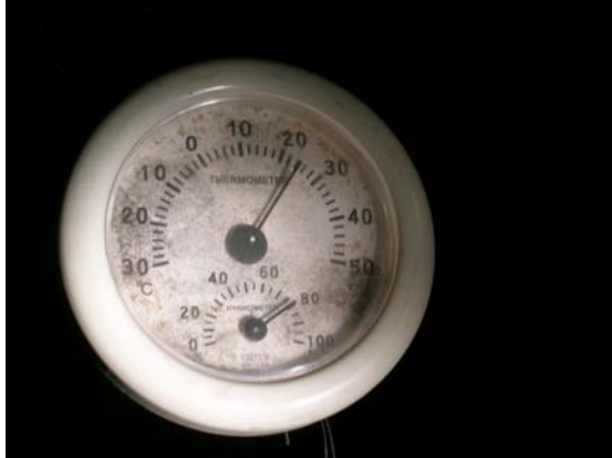
圖三 地下三樓固化設備房間溼度計顯示 80%相對溼度
