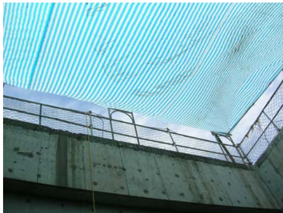
圖四 廠房 2 樓屋頂臨時開口僅以簡單帆布遮蓋
