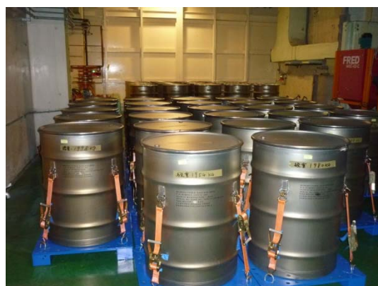
圖 4 012 館地下室廢樹脂暫存情形
