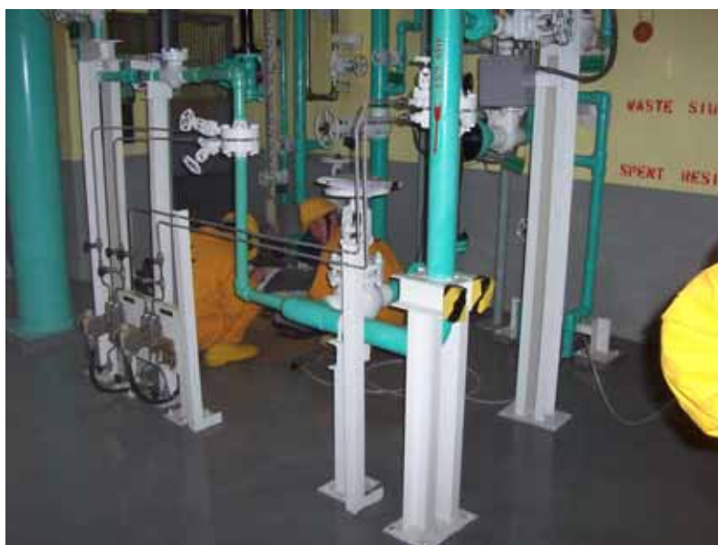
圖一 廠方人員測試管線壓力儀是否正常
