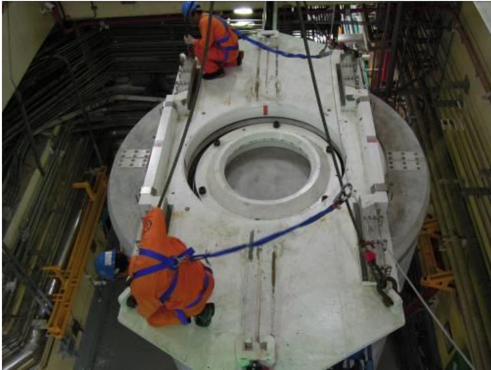
圖 3.2.43、於 VCC 上安裝銜接器
