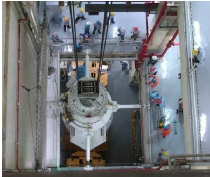
圖 3.2.29 傳送護箱外側二樓防震裝置展開並固定(1 of 2)
