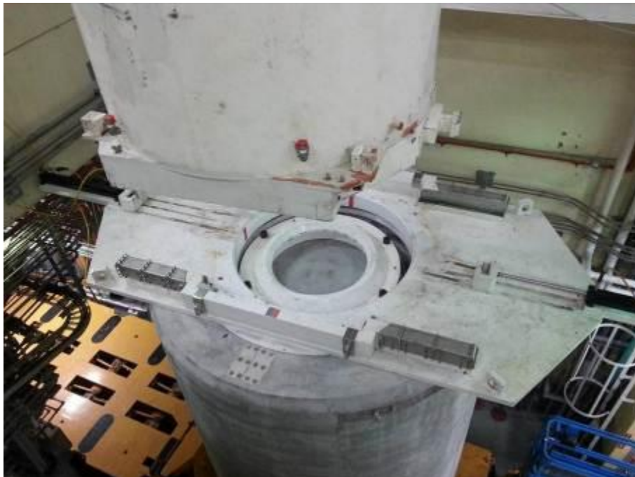
圖 3.2.32 密封鋼筒順利傳送進 VCC 內並將傳送護箱吊離
