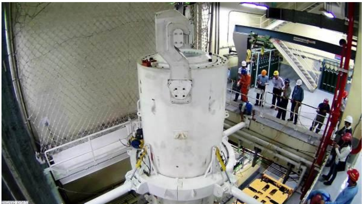
圖 3.2.30 傳送護箱外側二樓防震裝置展開並固定(2 of 2)
