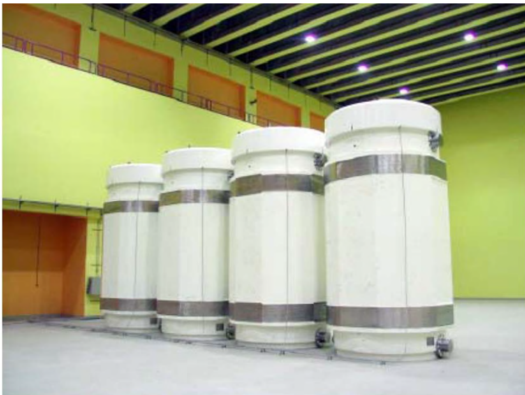
圖 2 貯存於空調系統廠房內之乾貯設施
