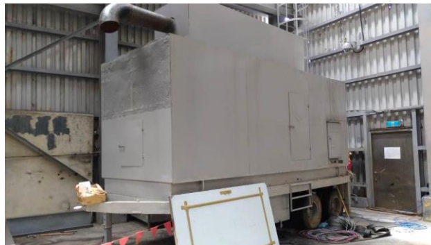
圖八 400 kW 柴油發電機無法正常啟動
