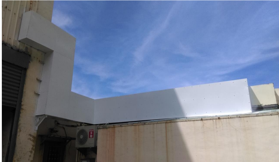
圖三 管制站後方之電纜線槽損壞應已完成改善
