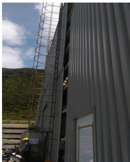
圖二 鋼構廠房 A 棟門口空隙
