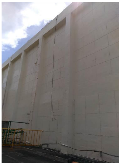
圖四 處理中心外牆垂掛之纜線 應盡速改善
