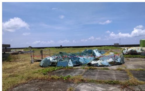
圖十 鋼構廠房屋頂隔熱板碎片已拉安全管制繩
