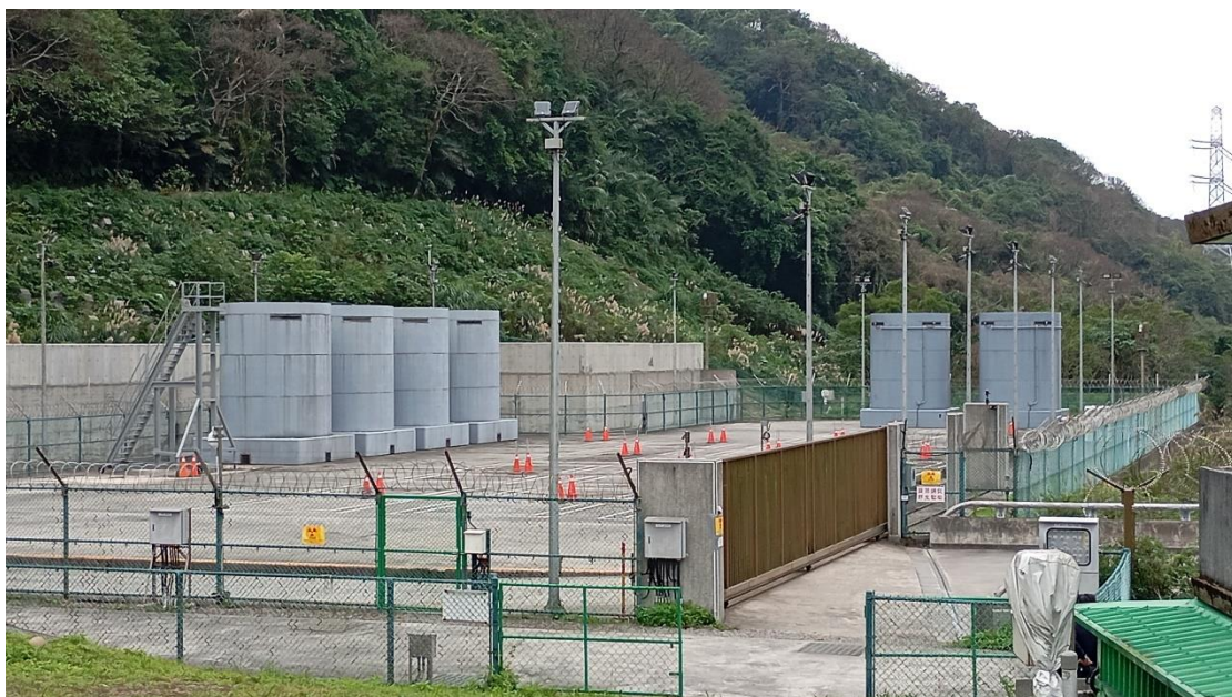
圖 4-1：核一廠用過核子燃料室外乾式貯存設施現況
