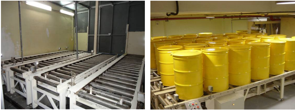
圖一 底漆乾燥暫存區及養生區，各可提供 22 桶廢棄物暫存
