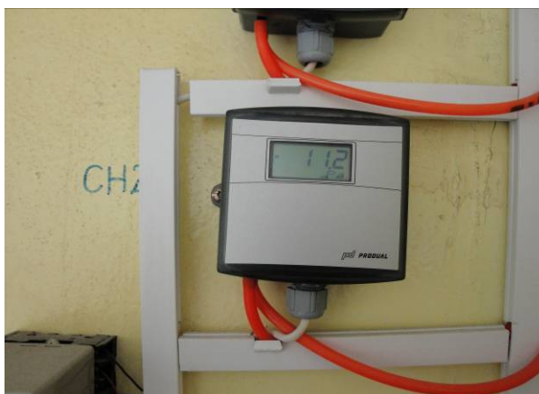
檢查處理中心負壓狀況
