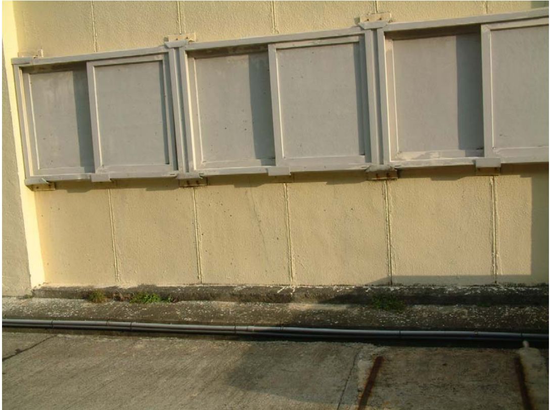
車庫幾扇未封閉且易跨越之矮窗戶
