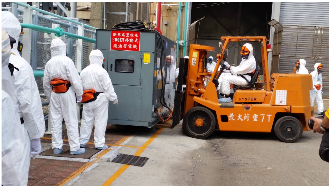
列置 480V 200KW 移動式柴油發電機
