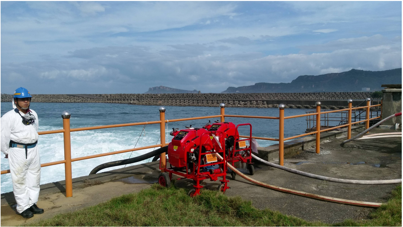
核能二廠出水口抽取海水灌至廠內排洪渠道
