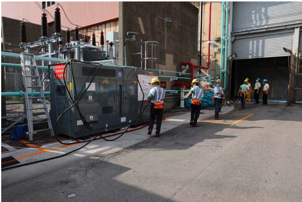
移動式 480V 200kW 柴油發電機引接演練
