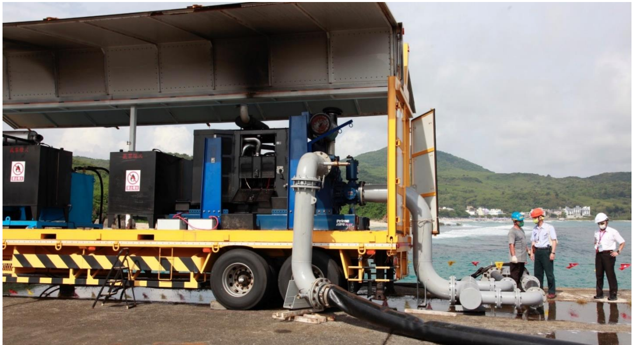
圖 4-17 核能三廠移動式第二熱沉佈線引接及抽海水演練
