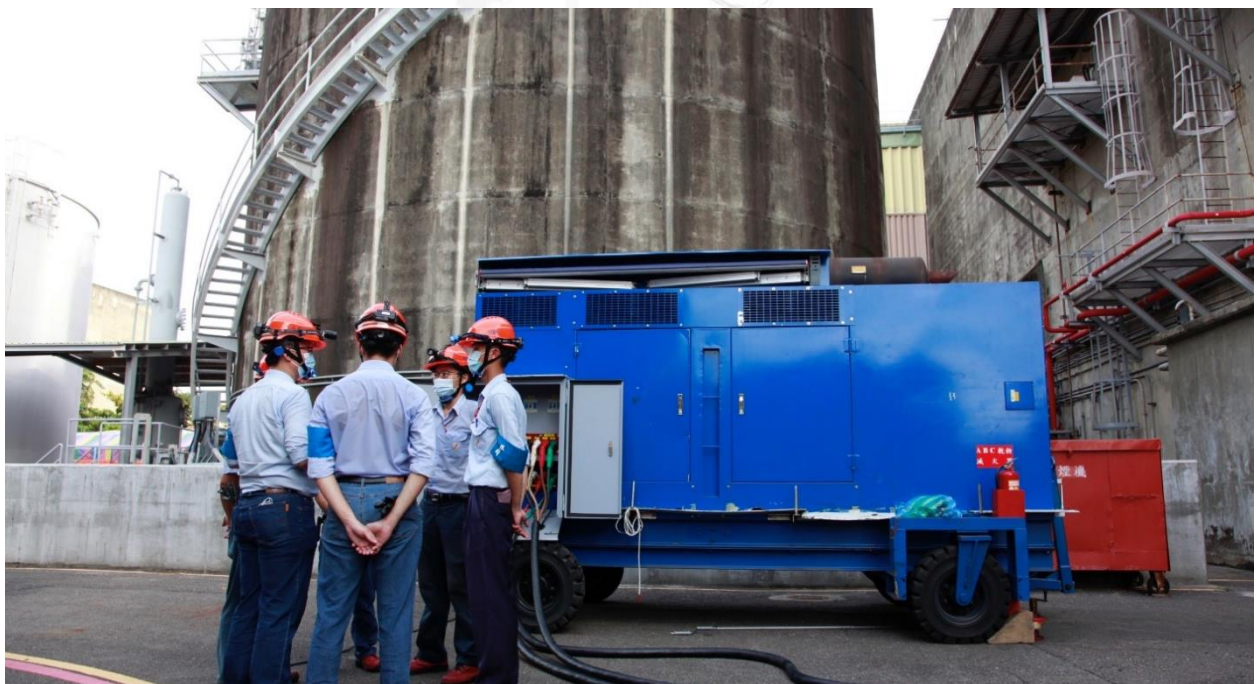
圖 4-16 核能三廠 480V 移動式柴油發電機演練
