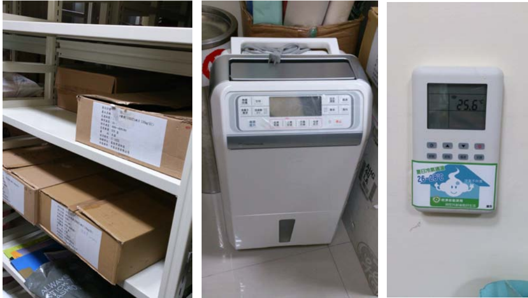
圖五、七堵區碘片集中儲備情形(備有料架、除濕及空調設備)
