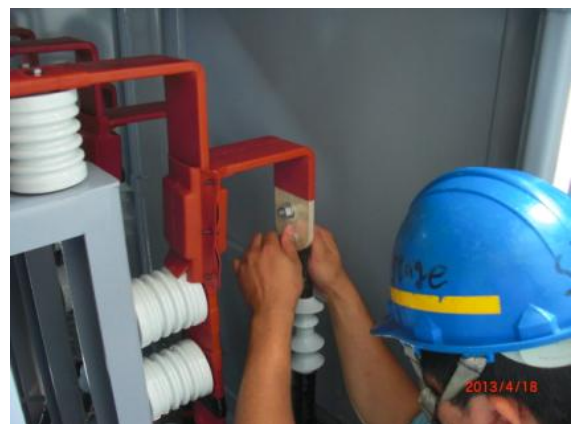
4.16kV 電纜連接至引接口
