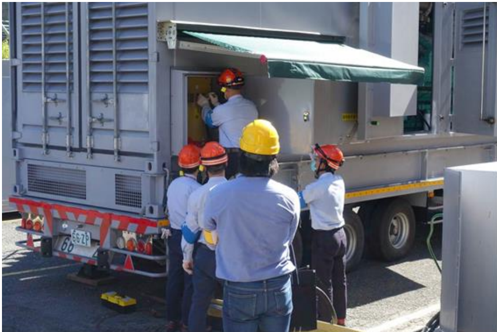
圖 4 4.16kV 移動式電源車引接演練視察
