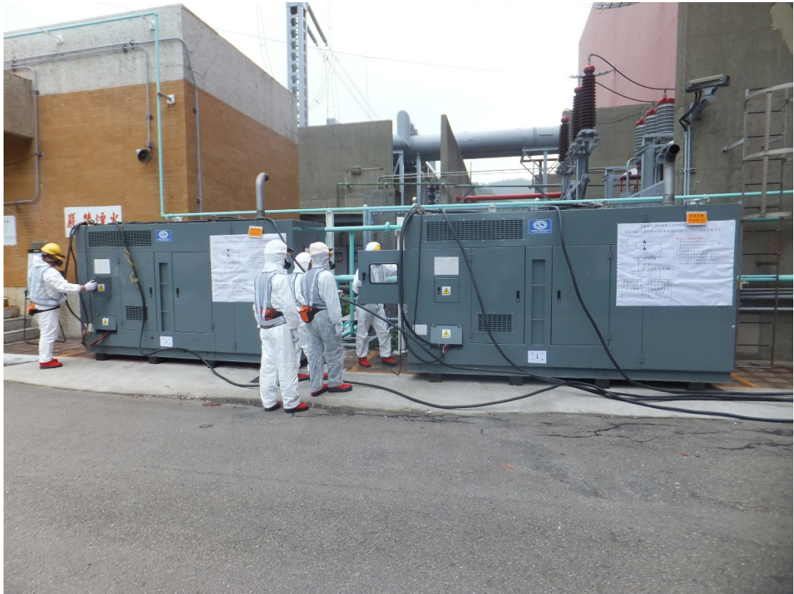
移動式 480V 200kW 柴油發電機引接作業
