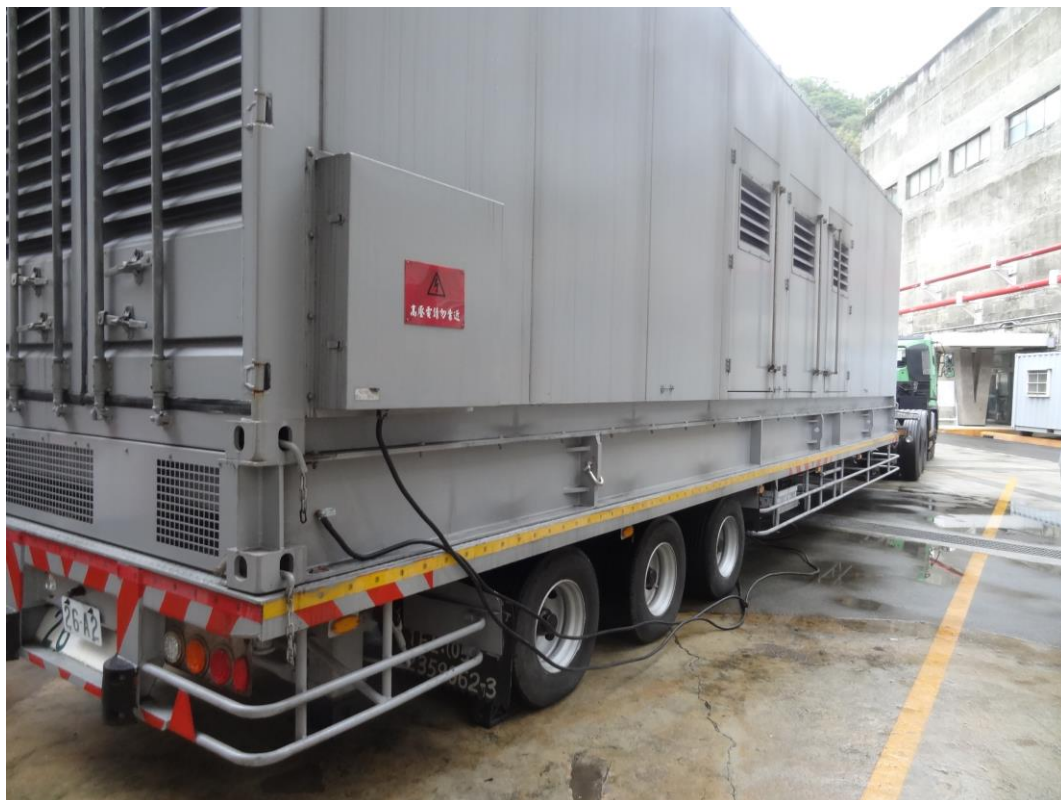
圖 3 4.16kV 1500kW 移動式柴油發電機列置演練
