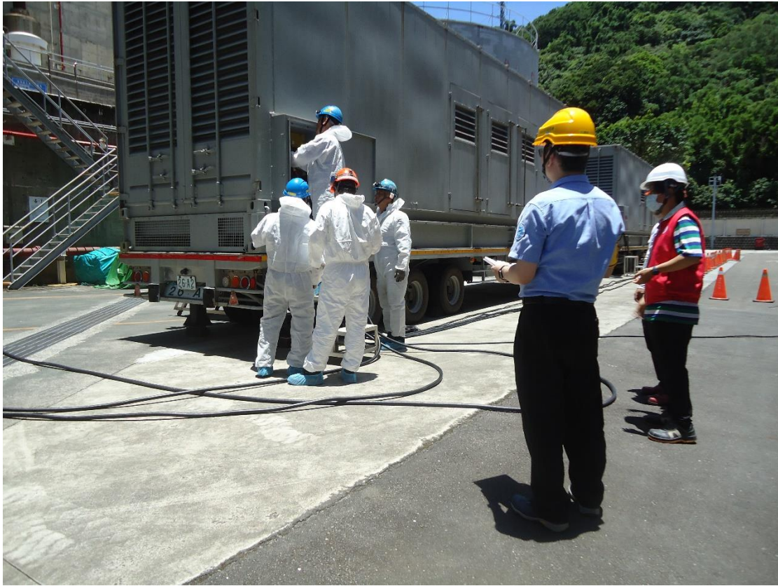
圖 3 4.16kV 電源車列置及引接演練視察
