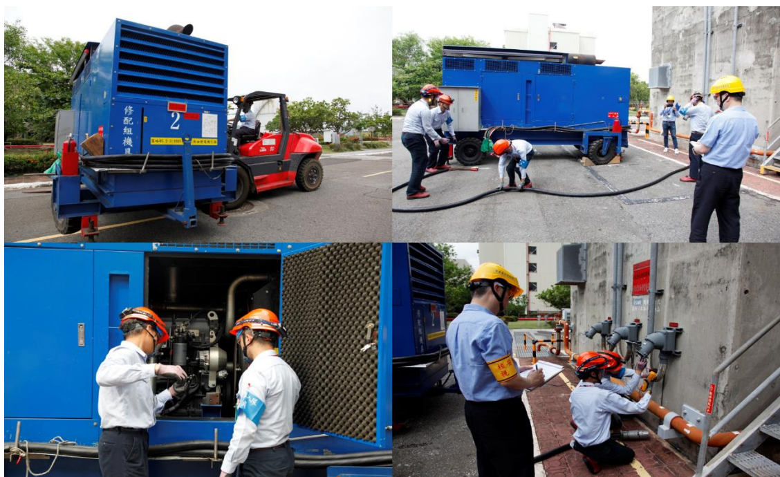
圖 7 核能三廠 480V 移動式柴油發電機列置演練視察
