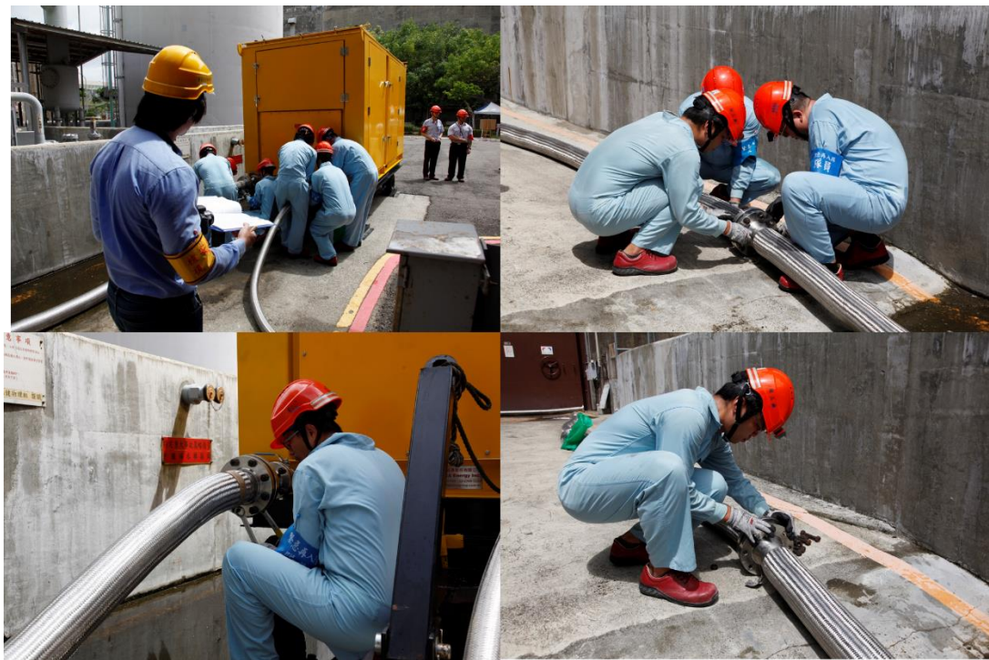
圖 6 核能三廠移動式高壓注水泵列置演練視察
