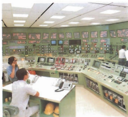
核一廠控制室
