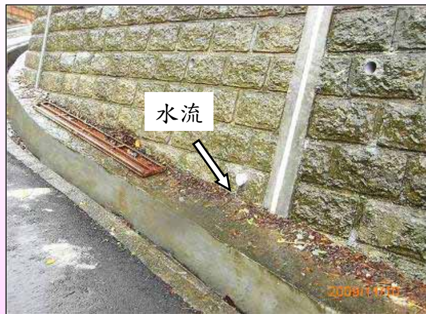
照片15：排水檢測
