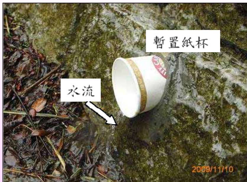
照片14：排水檢測
