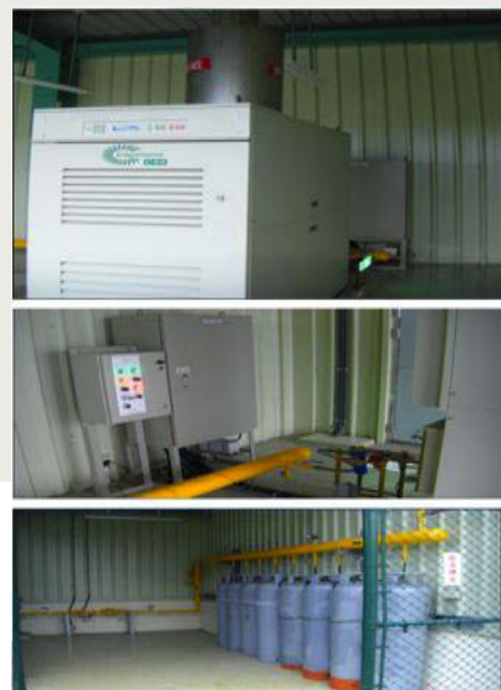
▲65 kW微氣渦輪機之建置
