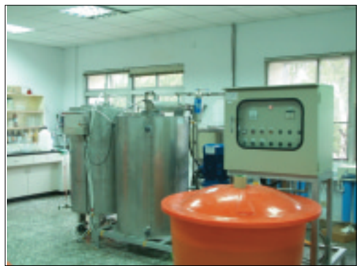
圖七十、逆滲透分離法之硼酸純化再利用設備
