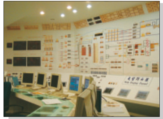
圖六十七、數位化儀控系統控制室人機界面模擬測試平台
