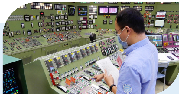
▲ 113 年 7 月 29 日查證核三廠 1 號機主控制室標示轉換作業執行情形
