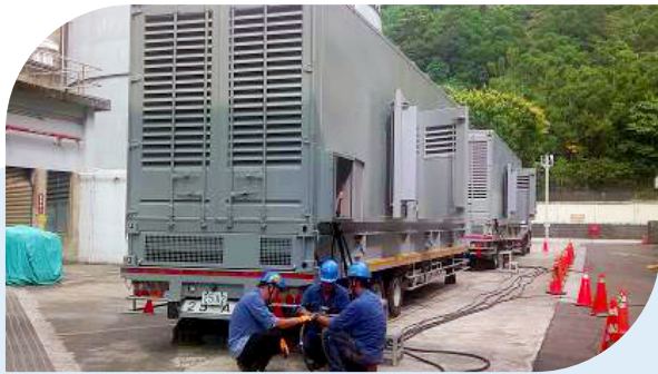
▲ 4.16kV 電源車列置與引接演練
