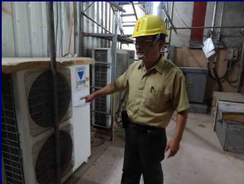
空調系統排氣盤及風扇 裝置室內
