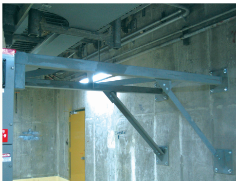
▲核能二廠電氣盤面新增之加固支架
