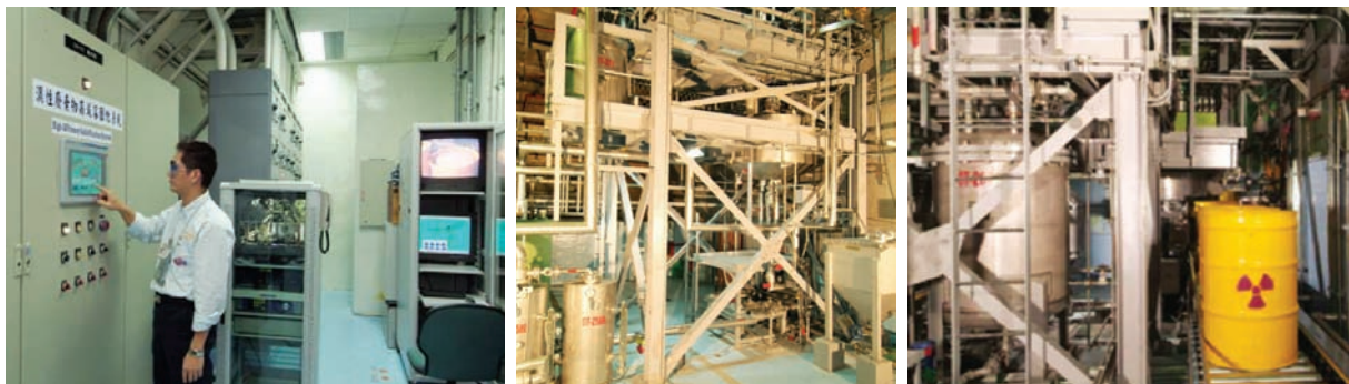
■ 圖七十二 高減容固化系統之PLC主控制盤及電腦 ■ 圖七十三 核二廠濕性廢料高減容固化系統 ■ 圖七十四 固化漿體承裝與廢棄物桶輸送設備
