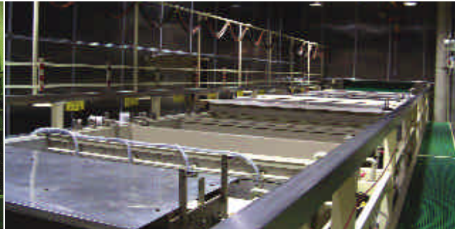
圖四十 污染隔離罩內化學及電化學除污設備
