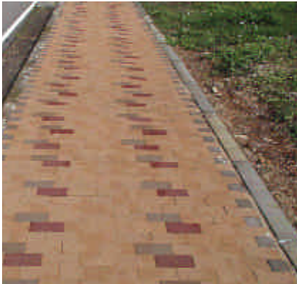
圖七十四 透水磚鋪設之人行道
