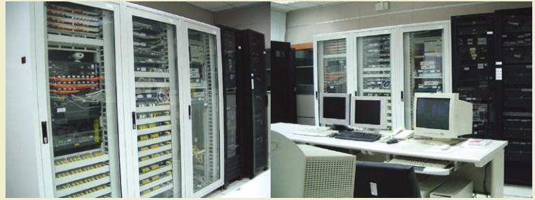
↑ 網路安全防禦設備：防火牆、防毒牆
