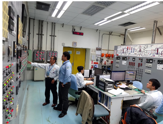
▲核二廠放射性廢棄物處理設施檢查作業
