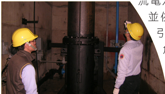
▲原能會視察員現場查證核二廠緊要海水泵室
