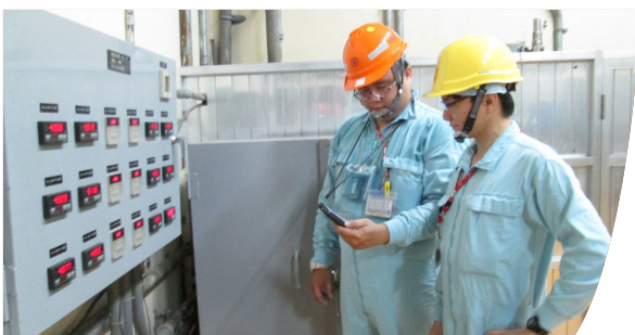
▲原能會視察員現場查證核三廠輔助廠房設備狀況
