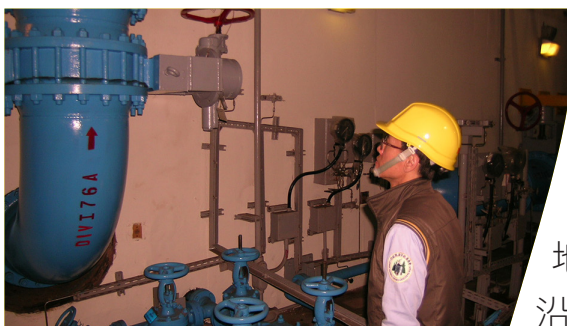
▲原能會視察員現場查證核二廠緊急爐心冷卻系統
