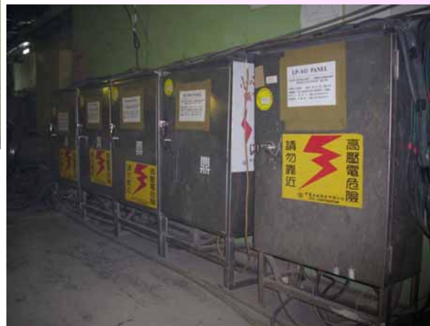
#1RB EL-1700 FMCRD MAINTENANCE AREA 設備整齊排列、美觀
