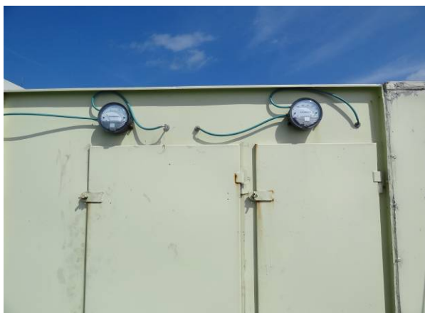
檢查處理中心通風設備
