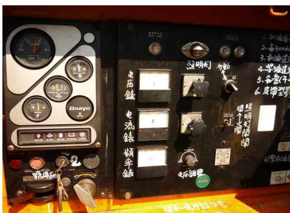
檢查處理中心電源設備
