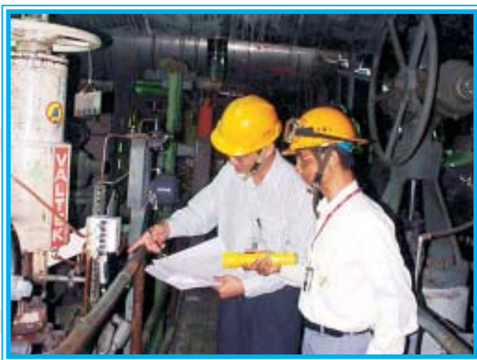
▲ 駐廠視察員巡視電廠現場設備
