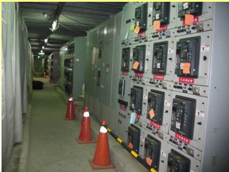
#1SGB電氣盤通道
