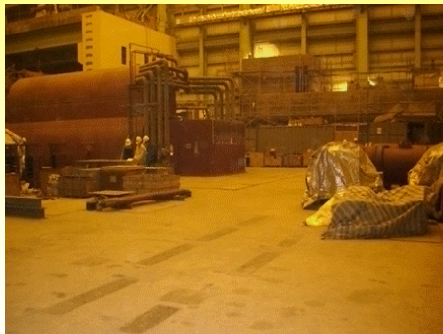
#1TB汽輪機廠房
