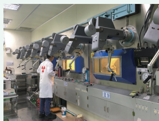
生產鉛室 · Production Lead Room
